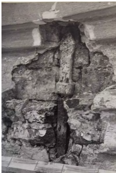
Илл. 37. ЛФИ «Спецпроектреставрация». Фотоснимок анкера (4-го), обнаруженного в зондаже № 11 на западном фасаде. 1981 г.
